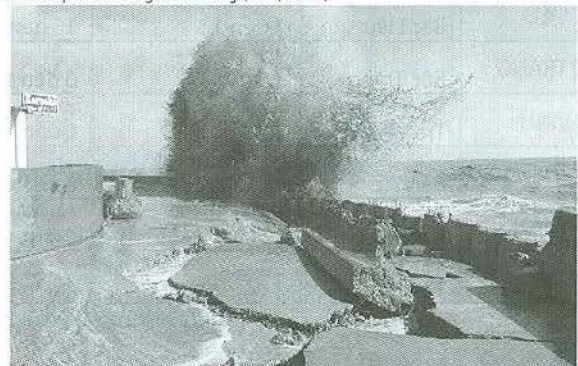
Hình 5. Sạt lở tại kè đê biển Gành Hào, Bạc Liêu (Báo Thanh Niên, 2017)
