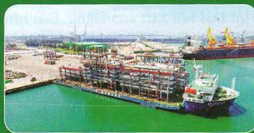
Công ty TNHH Công nghiệp nặng Doosan Việt Nam xuất khẩu 12 module khổng lồ đến UAE.
