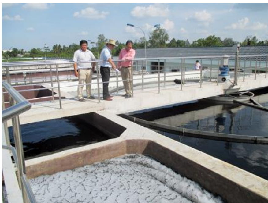
Nhà máy Xử lý nước thải tập trung KCN Trà Nóc, giai đoạn I có công suất 6.000m 3 /ngày – đêm.
