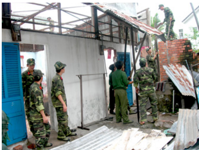
Hàng năm, lốc xoáy gây tốc mái đều xuất hiện trên địa bàn TP Cần Thơ. Trong ảnh: Lực lượng công an, bộ đội đang hỗ trợ người dân sửa chữa nhà cửa do lốc xoáy làm tốc mái, hư hại tại phường Hưng Lợi, quận Ninh Kiều.
