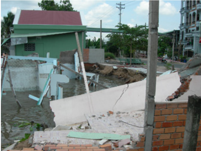
Nhiều căn nhà tại ấp Mỹ Ái, xã Mỹ Khánh, huyện Phong Điền bị sạt lở xuống sông Cần Thơ, gây thiệt hại cho bà con tại địa phương. Ảnh: V.T
